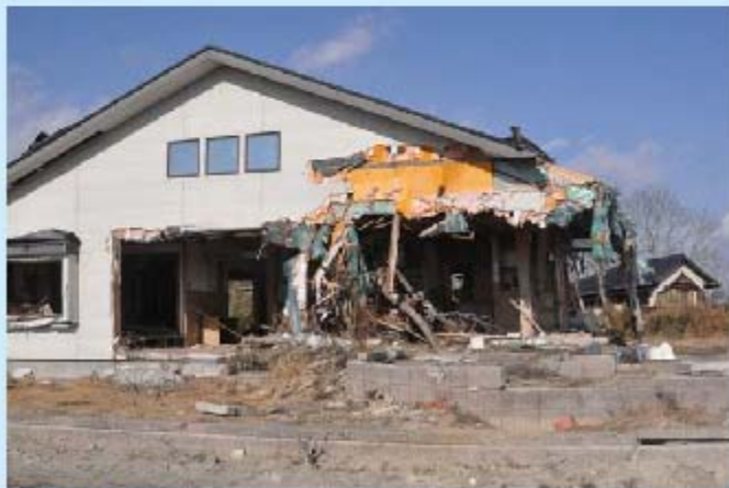
破壊された住宅。
