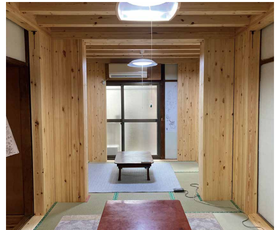
木質耐震シェルターを設置した部屋の様子
